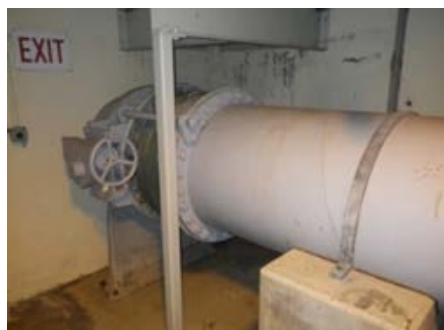
Biotower effluent pipe
